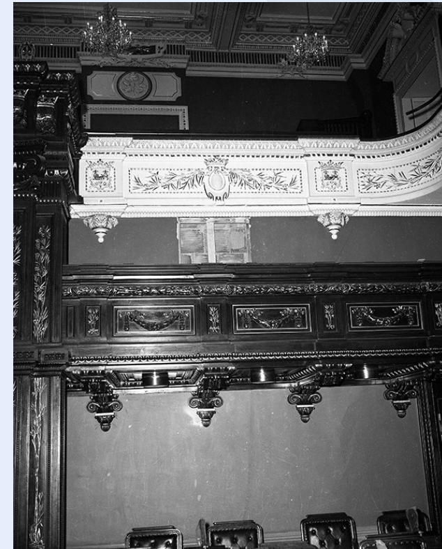
Travaux de rénovation au salon Bleu, 9 novembre 1966. 2153131. Collection Assemblée nationale du Québec, Photo Moderne Inc.
